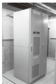
伝承館蓄電池
